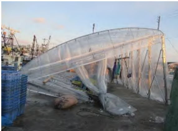
強風による簡易施設の被害
