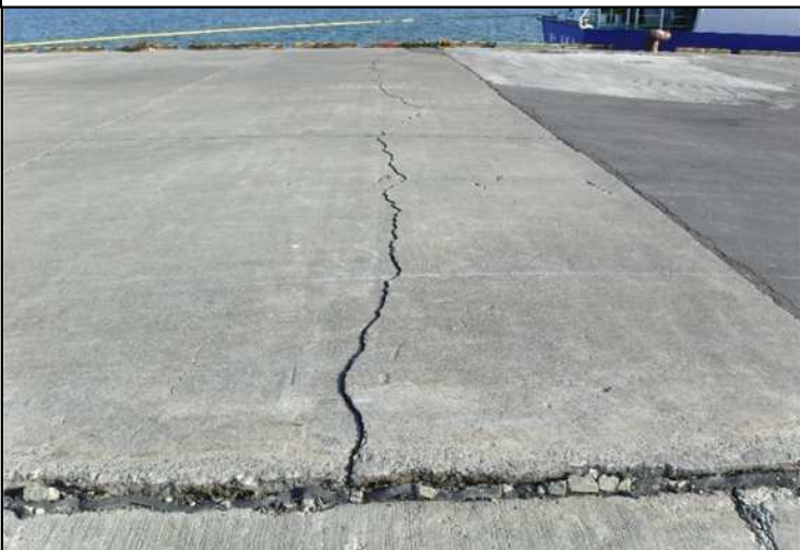
中央北ふ頭1号東岸壁(エプロン亀裂)
