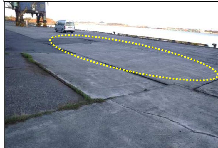
中央南ふ頭2号岸壁(エプロン沈下)
