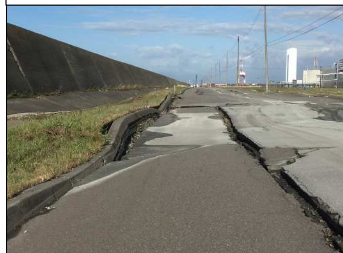
東港区B地区南護岸・東港東部南線 (道路の亀裂・沈下・陥没)
