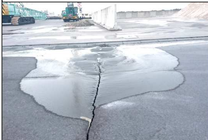
中央北ふ頭1号東岸壁背後の臨港道路 (液状化による噴砂)
