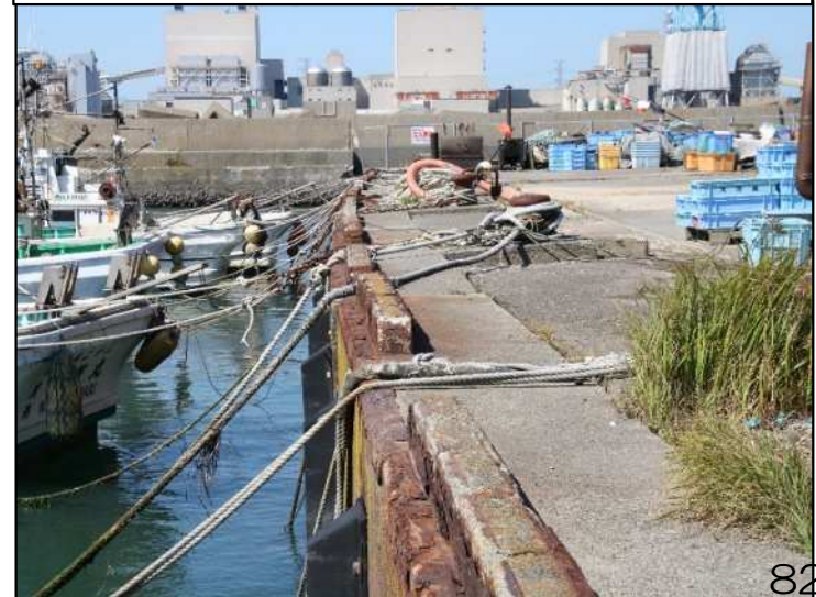
浜厚真地区船だまり(物揚場の腹み出し)
