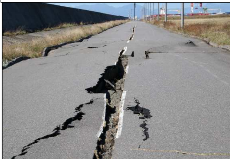
東港区B地区南護岸・東港東部南線 (道路の亀裂・沈下・陥没)
