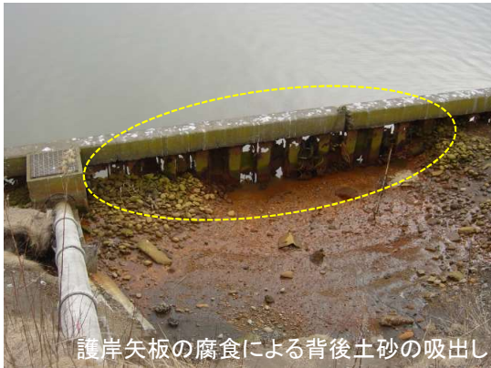
護岸矢板の腐食
